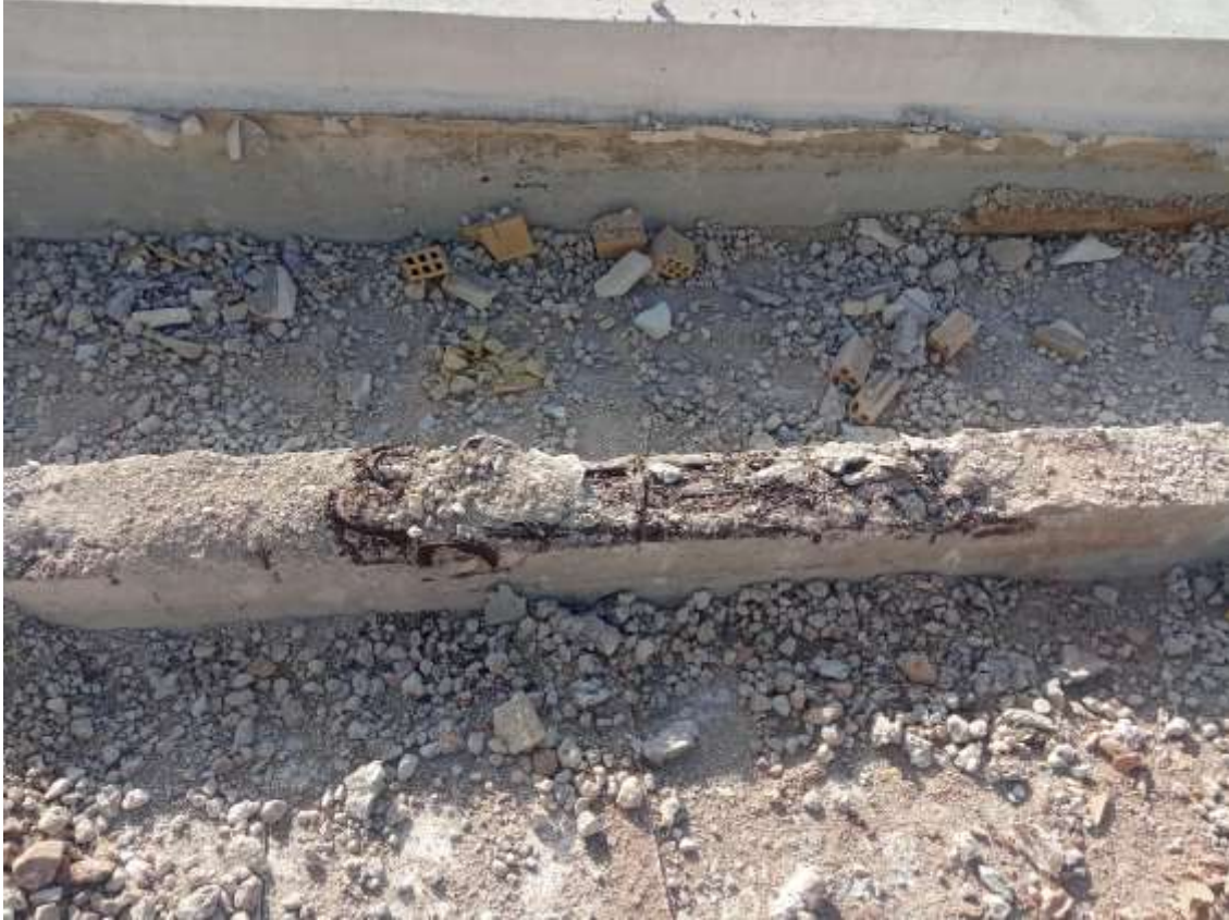
Εικόνα 1: 'Χάντρωμα' στις δοκούς οροφής ορόφου για αποκάλυψη του σπλισμού
