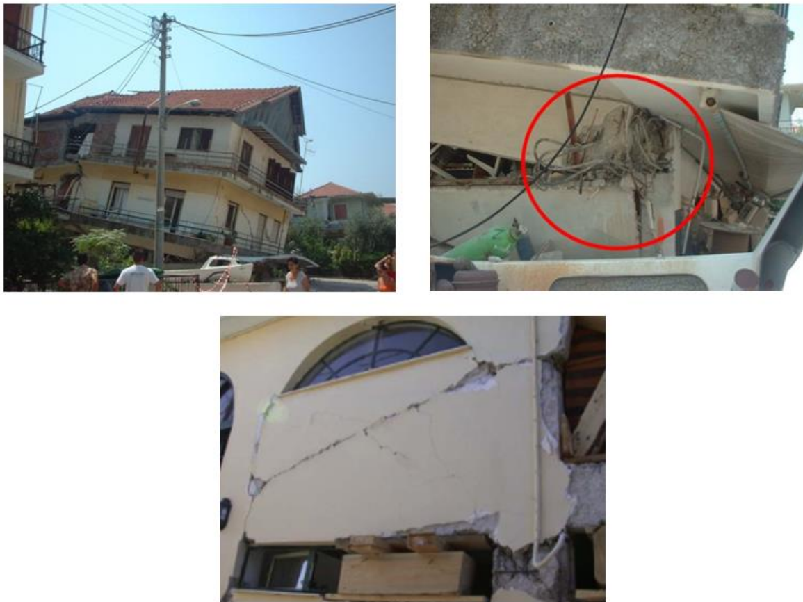
Σχήμα 1: Αστοχίες τοιχοπληρώσεων υπό την επίδραση σεισμού στην Λευκάδα το έτος 2003
