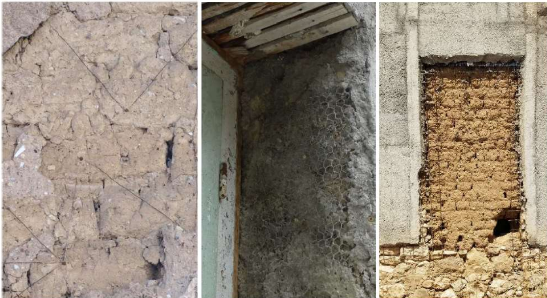
Εικόνα 8: Τυπικές επισκευές στην Πάτρα: αυτοσχέδιο μεταλλικό πλέγμα, κοτετσόσυρμα, εφαρμογή guinite.
