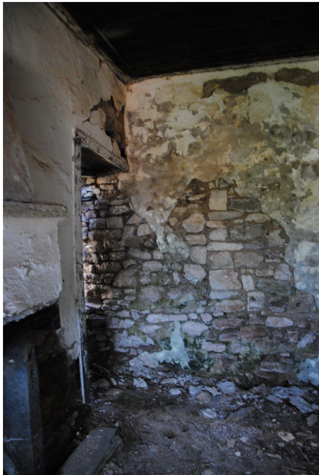
Σχήμα 12: Υγρασία στο Β τοίχο του δωματίου I.1.
