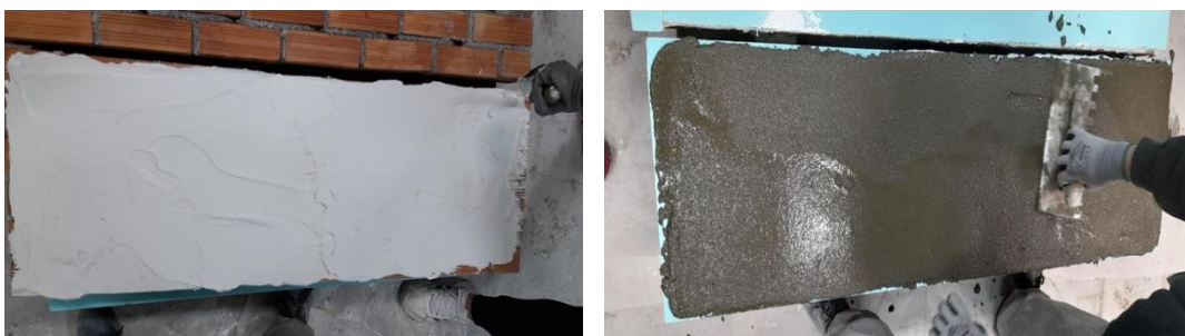
Σχήμα 4.4 Εφαρμογή στρώσης κονιάματος OPC στην τοιχοποιία πριν την τοποθέτηση πλάκας εξηλασμένης πολυστερίνης και εφαρμογή στρώσης κονιάματος AAM μετά την τοποθέτησή της
