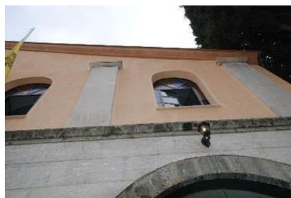
Σχήμα 30: Επισκευασμένες τριχοειδείς ρηγματώσεις στη δυτική όψη
