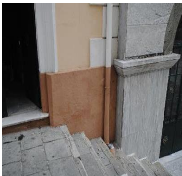
Σχήμα 35: Ανερχόμενη υγρασία δυτική όψη κωδωνοστασίου
