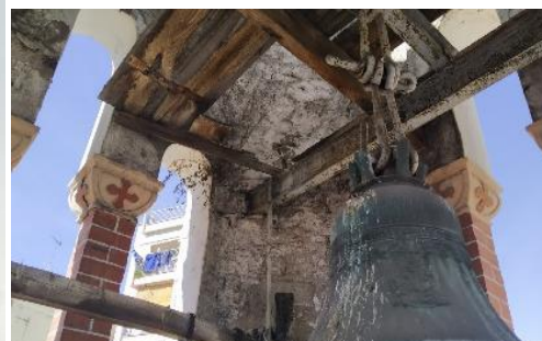
Σχήμα 37: Αποσάθρωση επιχρισμάτων & Οξείδωση σιδηροδοκών
