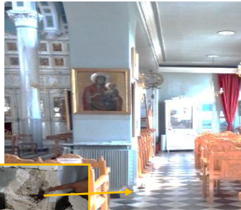
Σχήμα 44: Διάβρωση οπλισμού εσωτερικού πλαισίου
