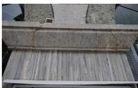
Σχήμα 29: Ρηγματώσεις ορθομαμάρωσης στη δυτική όψη
