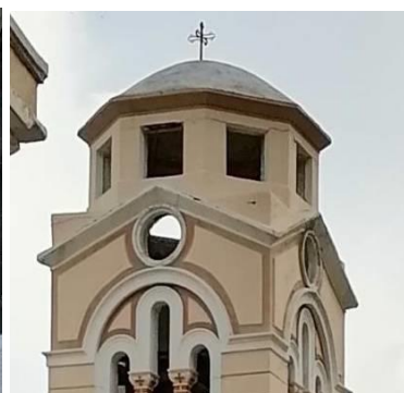
Σχήμα 36: Οριζόντιες ρηγματώσεις στη βάση της θολωτής επιστέγασης
