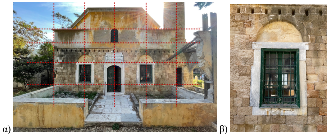
Σχήμα 7: (α) Οργάνωση των ανοιγμάτων της πρόσοψης του τεμένους (ΒΔ όψη) (β) Παράθυρο ΒΔ όψης με μαρμάρινο πλαίσιο και τοξωτό υπέρθυρο
