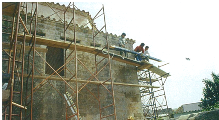
Σχήμα 16: Διαδικασία τοποθέτησης νέων ξυλοδεσιών κατά την αποκατάσταση του τεμένους Χαμζά Μπέη στην Μεσαιωνική πόλη της Ρόδου. [10]
