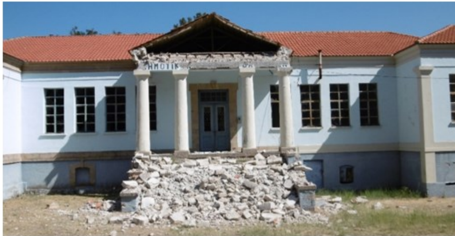
Σχήμα 8.1.: Αποκόλληση και πτώση τυμπάνου αετώματος λόγω σεισμού στην είσοδο δημοτικού σχολείου.
