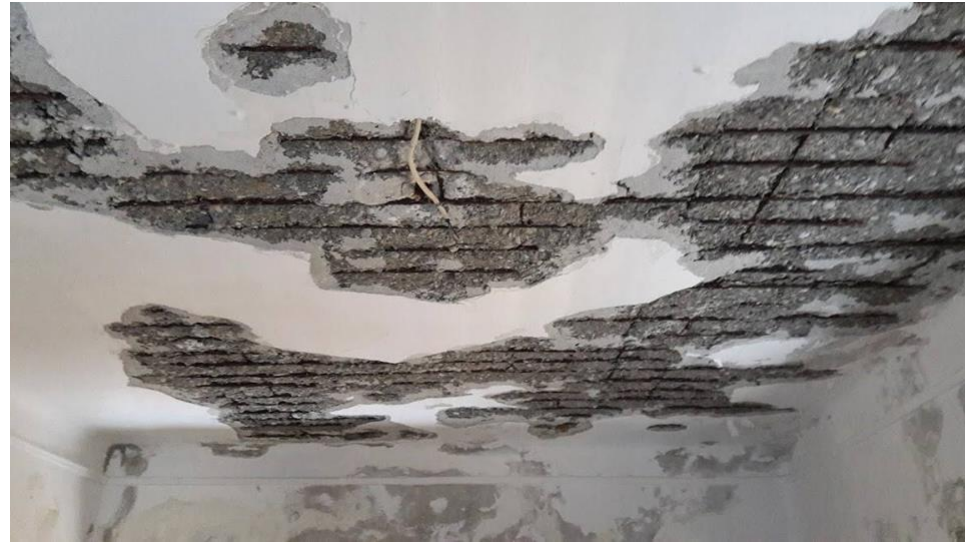
Αποκόλληση οροφής στην Ρόδο
