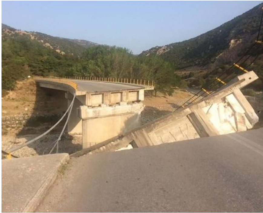
Κατάρρευση γέφυρας του ποταμού Κομπάτου, στην Ξάνθη
