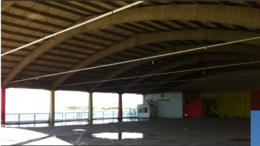
Άποψη πριν την κατάρρευση
