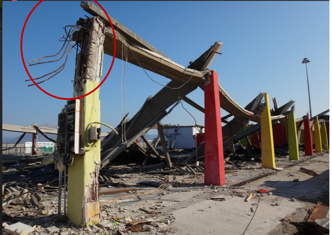
Άποψη μετά την κατάρρευση
