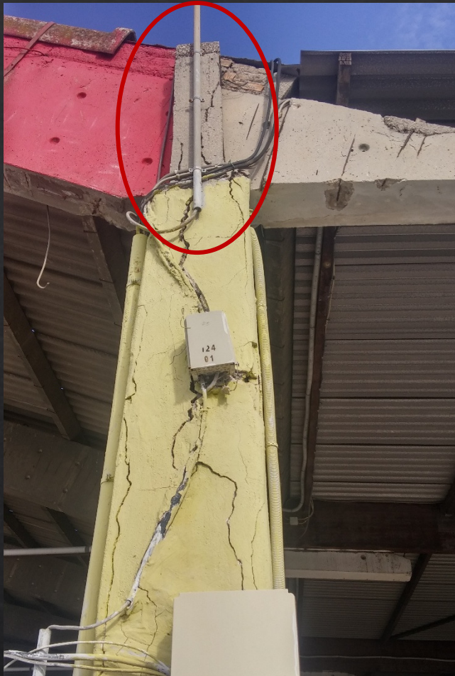
Η ακραία αντιστήριξη πριν και μετά την κατάρρευση
