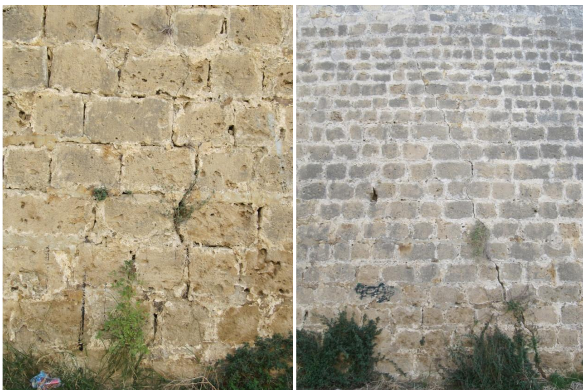
Εικόνα 18. Εφελκυστικές καθ' ύψος κατακόρυφες ρηγματώσεις και εμφάνιση βλάστησης ανάμεσα στους αρμούς. [10]
