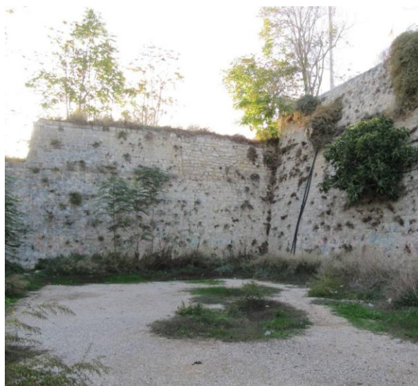
Εικόνα 28. Παθολογία ανατολικού ορεκίονε προμαχώνα Μαρτινέγκο. Στα δεξιά διακρίνεται ο σωλήνας απορροής νερών του Γ.Σ. Εργοτέλη. [10]
