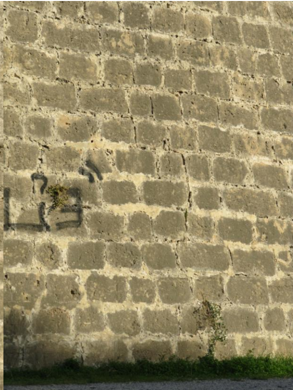
Εικόνα 24. Εφελκυστικές καθ' ύψος κατακόρυφες ρηγματώσεις και εμφάνιση βλάστησης ανάμεσα στους αρμούς. [10]
