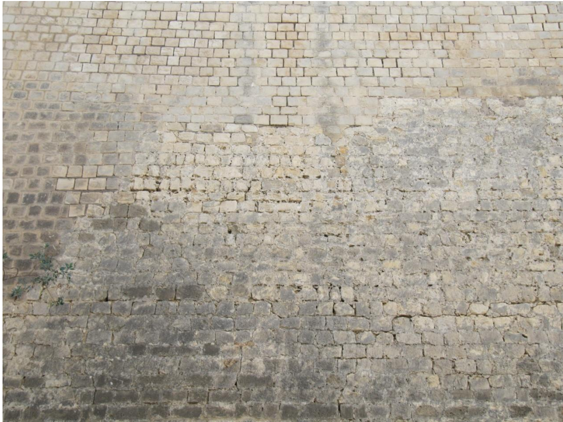
Εικόνα 19. Αποσάθρωση κονιάματος και διάχυση πάνω στους λίθους. Εμφάνιση κρούστας λόγω μικροοργανισμών και ρύπανσης του αέρα. [10]
