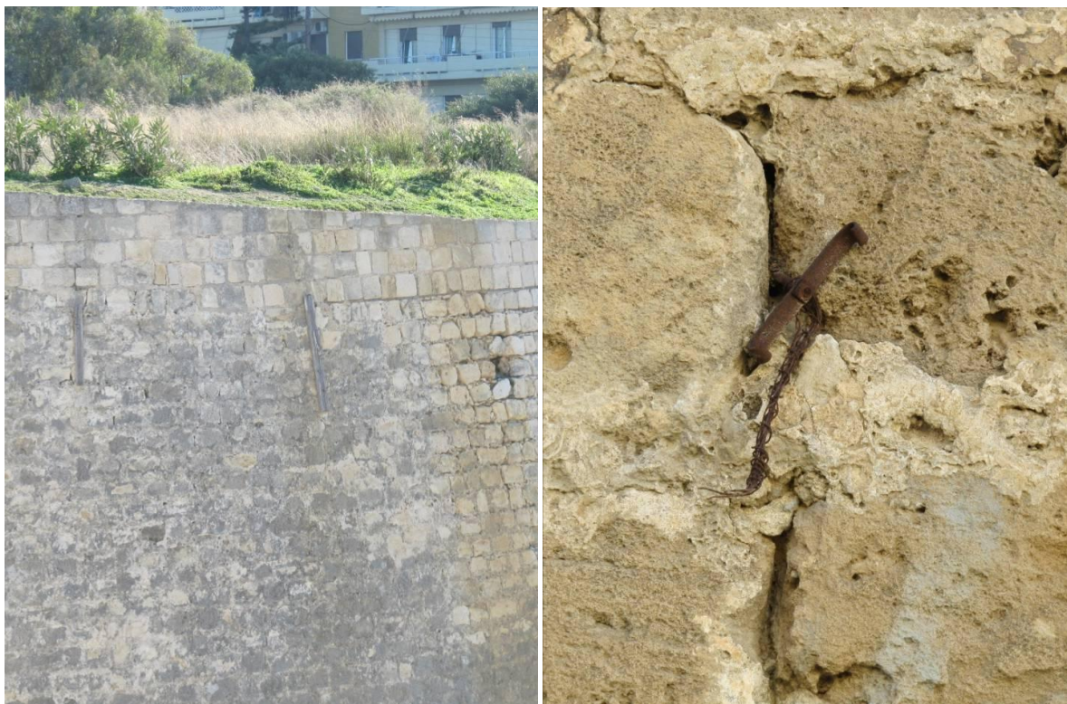
Εικόνα 21. Αγκυρώσεις από προηγούμενες επεμβάσεις αποκατάστασης για συγκράτηση της λιθοδομής. [10]
