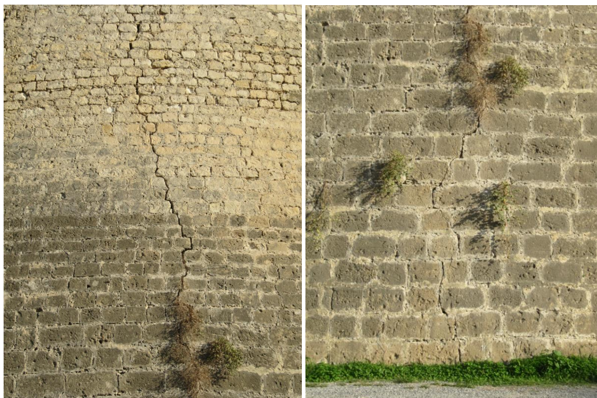
Εικόνα 22. Εφελκυστικές καθ' ύψος κατακόρυφες ρηγματώσεις, σπάσιμο λίθων και εμφάνιση βλάστησης ανάμεσα στους αρμούς. [10]
