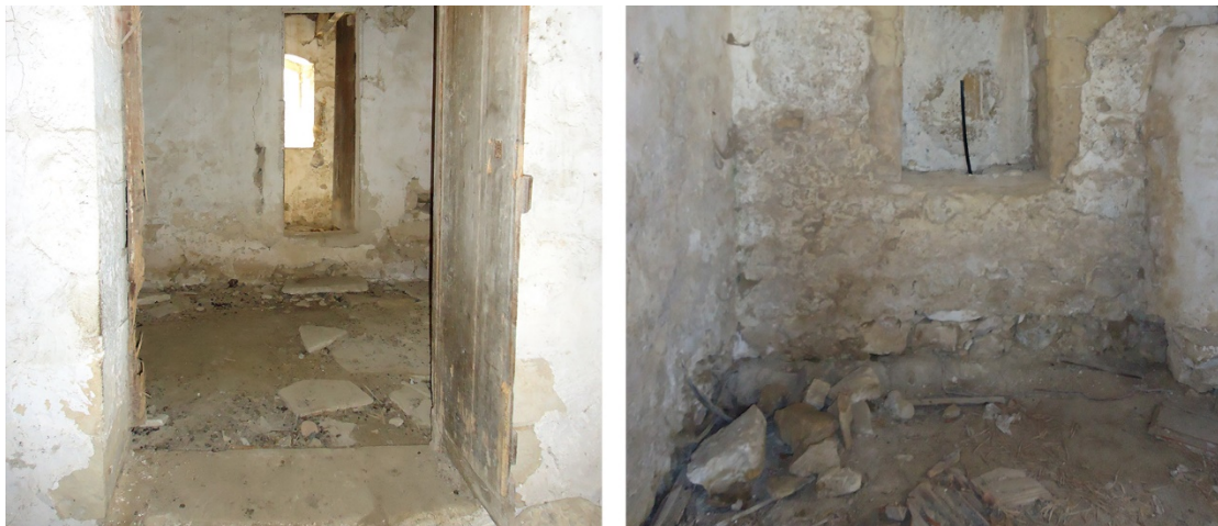
Εικόνα 10,11: Απουσία δαπέδου ισογείου
