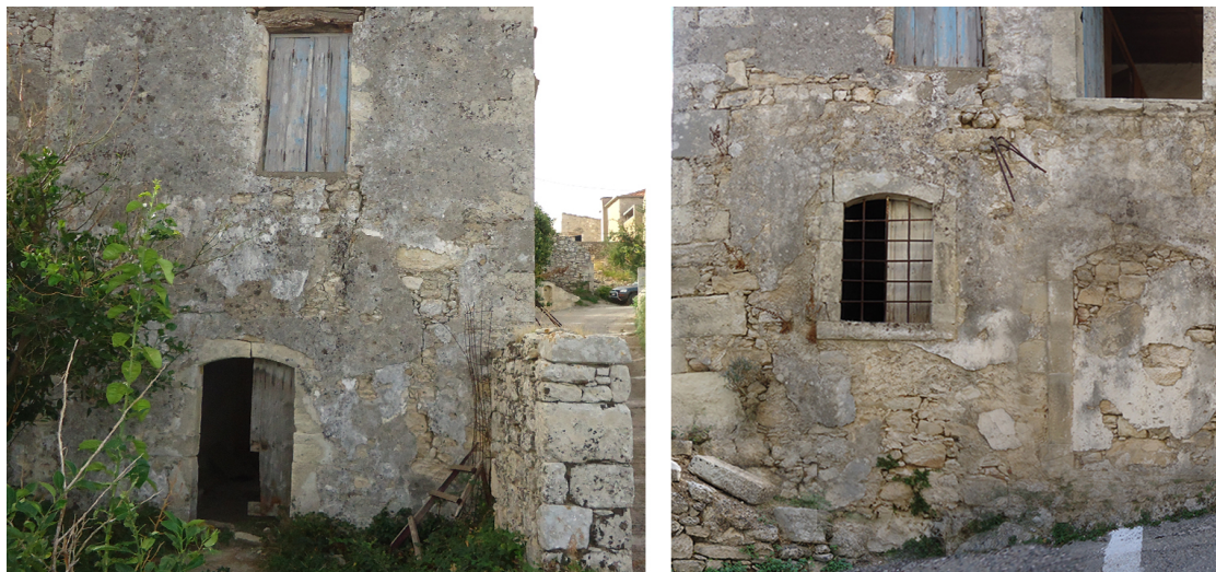
Εικόνα 15,16: Ρηγματώσεις που ξεκινούν από το έδαφος θεμελίωσης μέχρι το κάτω μέρος των ανοιγμάτων στη νότια και δυτική όψη αντίστοιχα
