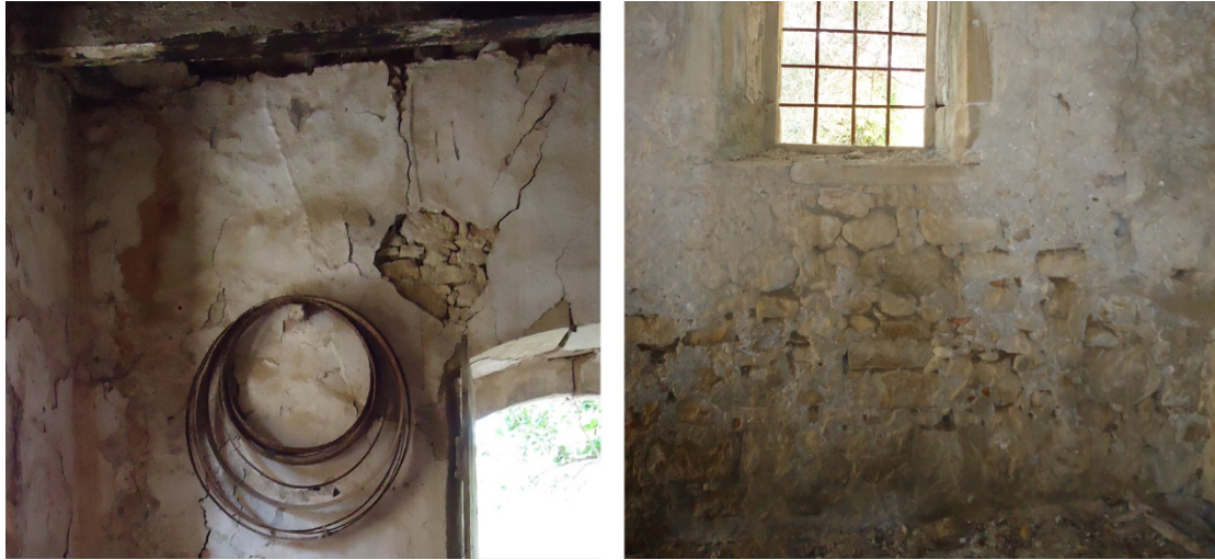
Εικόνα 13,14: Πτώση επιχρίσματος και αποκάλυψη δομικού υλικού στο εσωτερικό του κτιρίου
