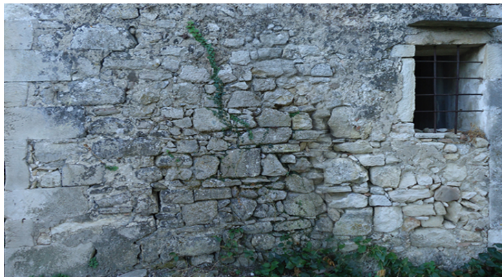
Εικόνα 12: Πτώση επιχρίσματος και αποκάλυψη δομικού υλικού στη βόρεια όψη
