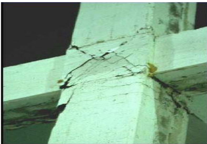
Σχ.2 : Διατμητική αστοχία κόμβου με αποφλοίωση σκυροδέματος [3]
