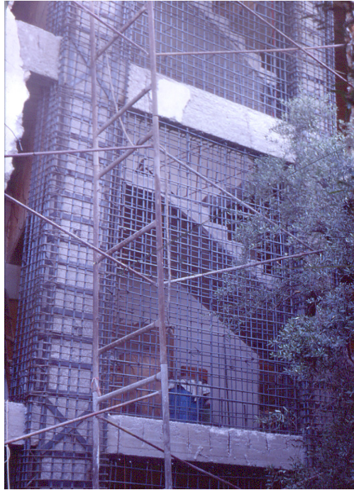
Σχήμα 5.16: Κατασκευή μανδύων Ο.Σ. μαζί με την εφαρμογή της τεχνικής του μεταλλικού κλωβού
