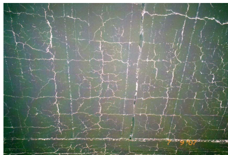
Εικόνα 12: Πλάκα οπλισμένου σκυροδέματος, χαρακτηριστικές πολλαπλές ρωγμές [11]
