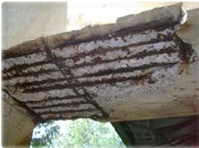
Σχήμα 1: Διαβρωμένη δοκός οπλισμένου σκυροδέματος [8]
