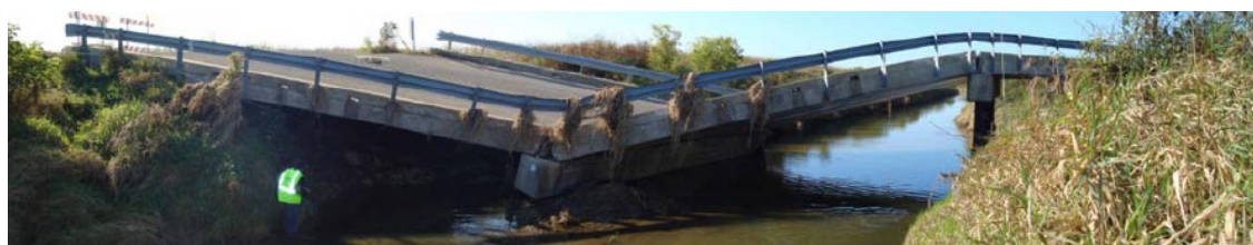
Σχήμα 10: Κατάρρευση της γέφυρας NO. SN 019-5010[13]
