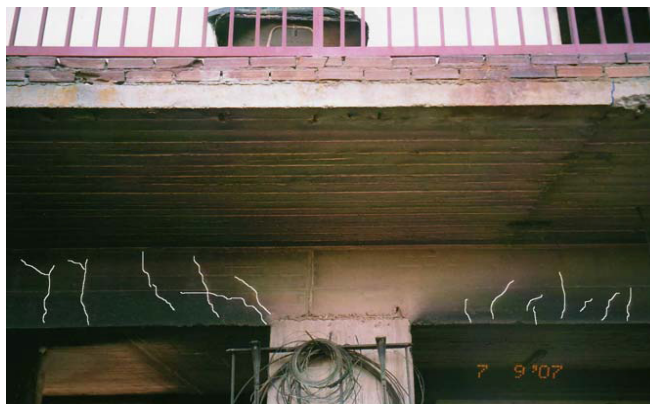
Εικόνα 11: Χαρακτηριστικές πολλαπλές καμπτικές και διατμητικές ρωγμές δοκών[11]
